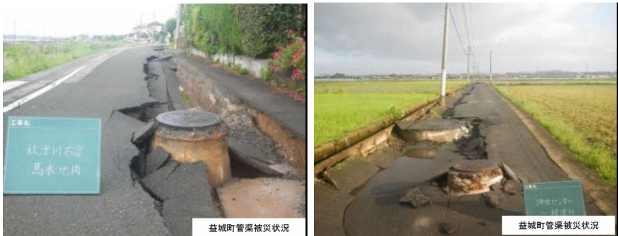
写真2-1-6 地震による下水道施設の被害例 マンホール突出状況（益城町内）
