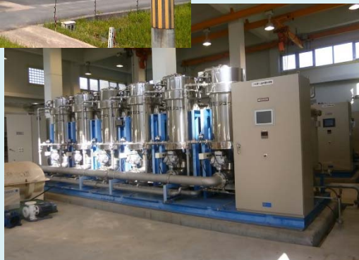
芦洲浄水場（膜ろ過モジュール）
