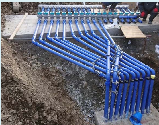
堀第1水源（逆洗浄配管）
