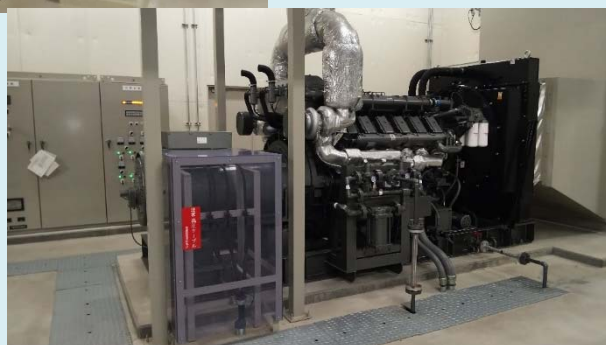
堀浄水場（自家発電設備）
