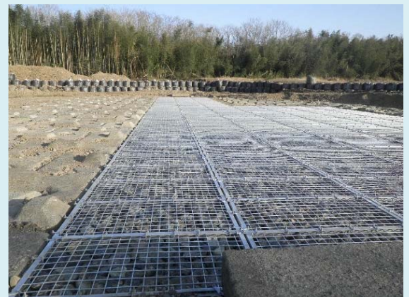
堀第1水源（集水施設）
