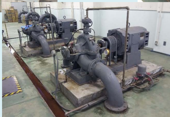
堀浄水場（送水ポンプ）
