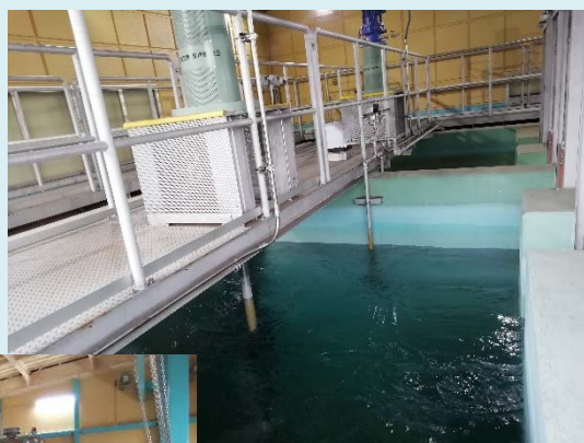
堀浄水場（膜ろ過混和槽）
