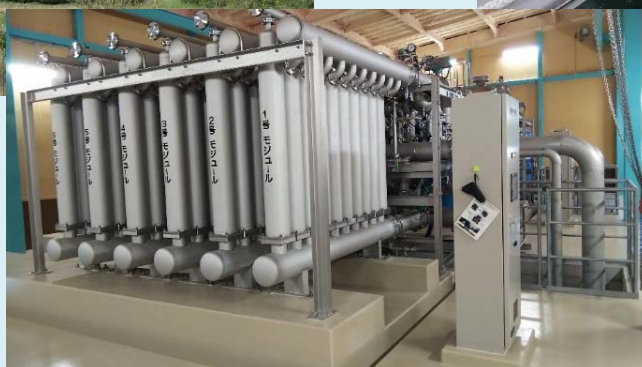
堀浄水場（膜ろ過モジュール）
