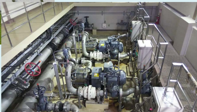
下荒河浄水場（送水ポンプ）
