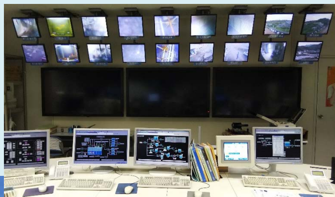
上下水道部庁舎（集中監視システム）
