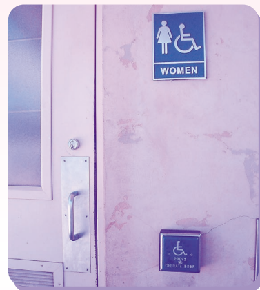
ボタンで開閉するトイレ (米国・アリゾナ州)
