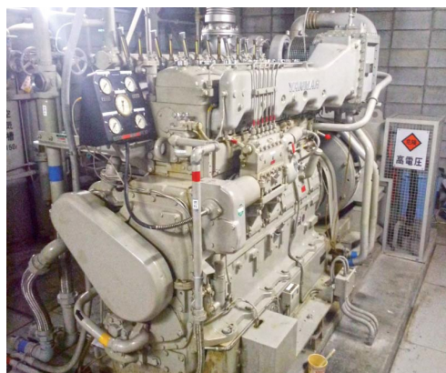
45年経過している本庁舎非常用発電機
