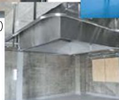
火災消火訓練室(2F)
