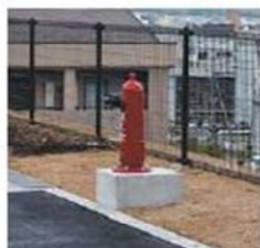
消火栓(訓練用)
