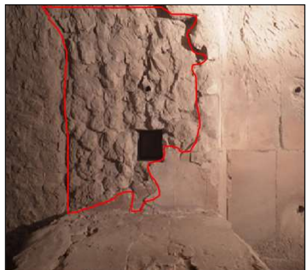
【1号炉ガス冷却室横煙道】
