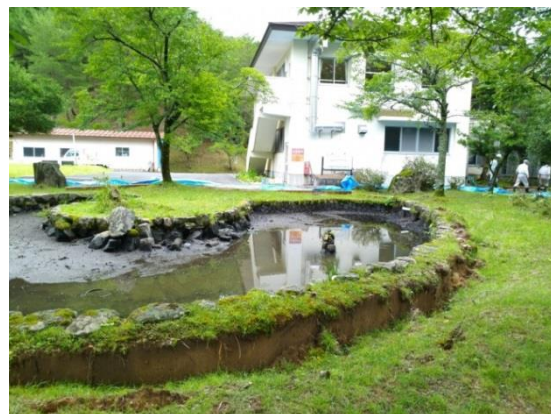
池周辺の地盤沈下 (敷地内)
