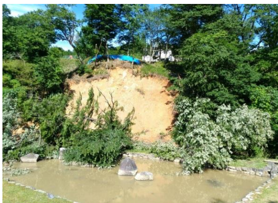
法面崩落状況
