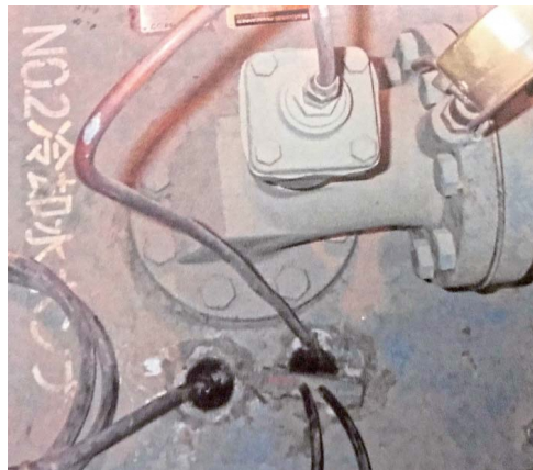
汚水が流入した荒河排水機場、第2排水ポンプの冷却水ポンプ
