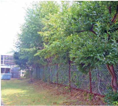
緩衝緑地からはみ出る樹木
