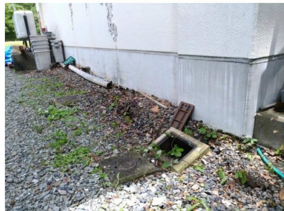
こぶし荘裏面被災箇所
