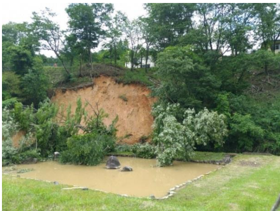
法面崩落被災箇所
