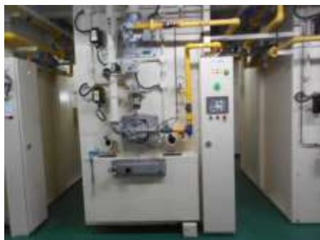
火葬炉制御盤
