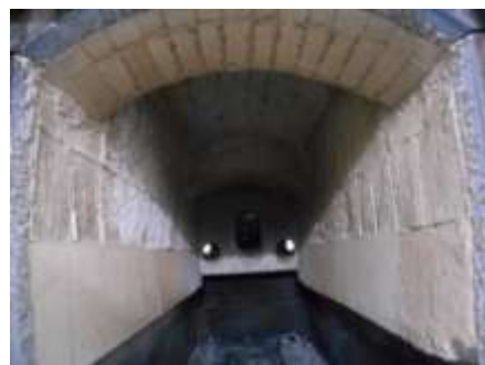
火葬炉内の耐熱ブロック
